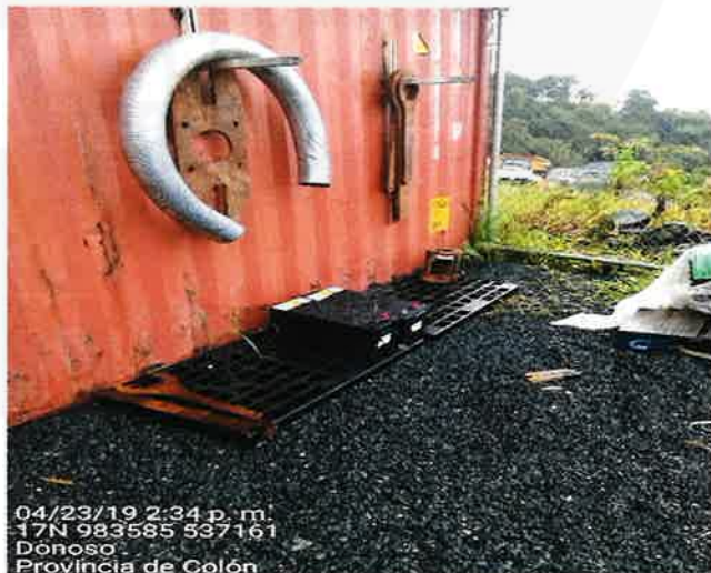
Fig. 2.5. En la inspección realizada al Taller TMF, se evidenció batería de equipo pesado (Camiones) sin medida de contención secundaria y a la intemperie a la lluvia.
