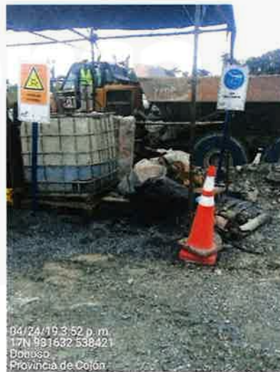
Fig. 1.5. En el área del taller FCC se pudo evidenciar, que el área de almacenamiento de los desechos peligrosos, no contaba con berma de contención secundaria.
