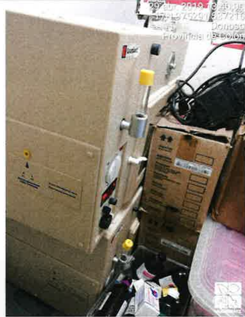
Fig. N° 15.4. Máquina para esterilizar instrumentos fuera de funcionamiento.
