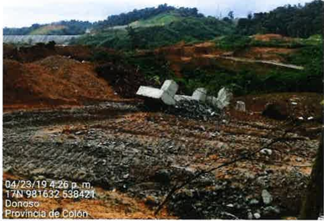
Fig. 2.3. En el área de Botadero del TMF, se evidenció la disposición de material tipo plástico (tuberías Plásticas), caliche, acero de construcción.
